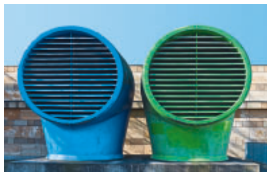
1 Stuttgart, Neue Staatsgalerie, Abluftrohre.
